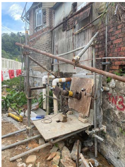
圖 23 及圖 24：事涉人造斜坡在維修後的狀況 (由屋宇署提供)
