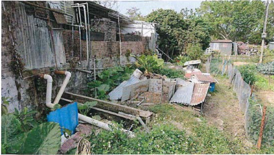
图 19：事涉人造斜坡在进行代办工程前的状况 (由屋宇署提供)
