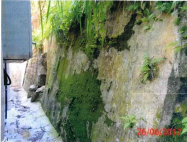
图 11：屋宇署提供有关个案（七） 所涉的斜坡于维修前的图片
