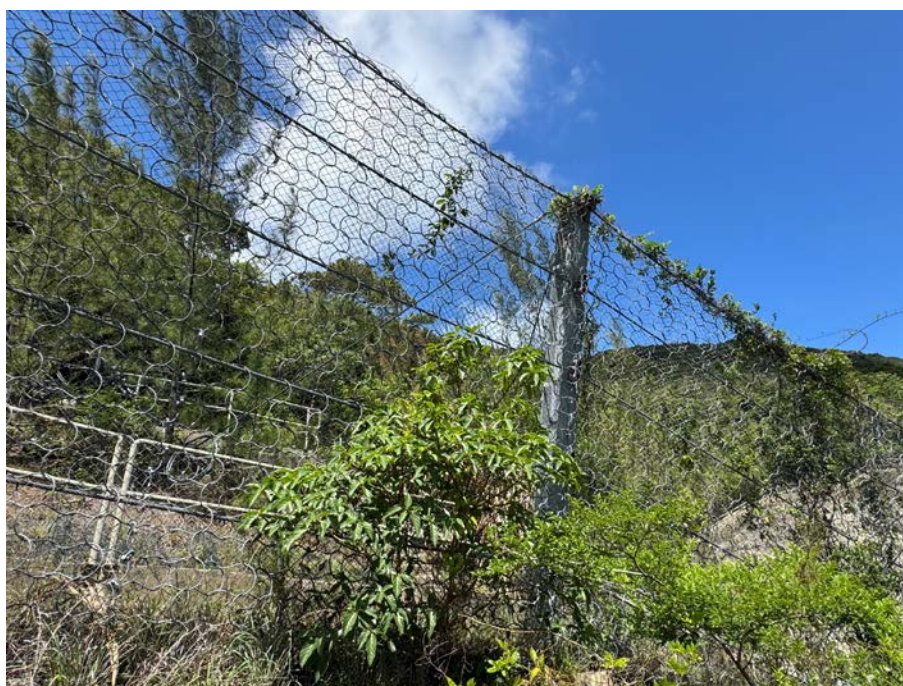
图 1：柔性防护网 （公署人员拍摄）
