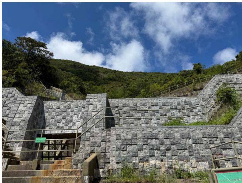
圖 3：位於淺水灣道的泥石壩 ( 公署攝於 2025 年 5 月的實地視察 )
