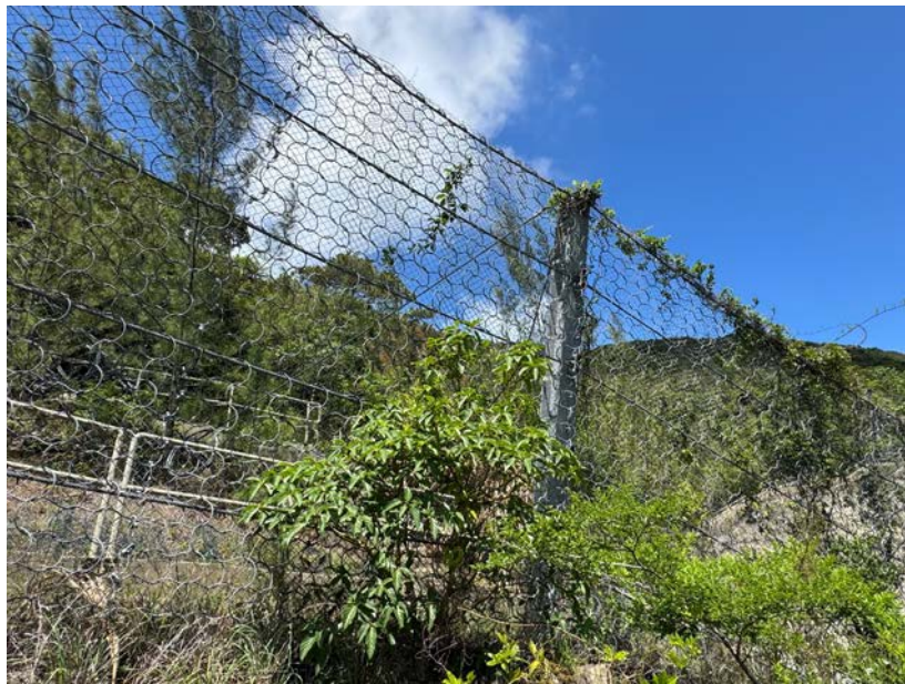
圖 2：位於淺水灣道上方的柔性防護網 （公署攝於 2025 年 5 月的實地視察）
