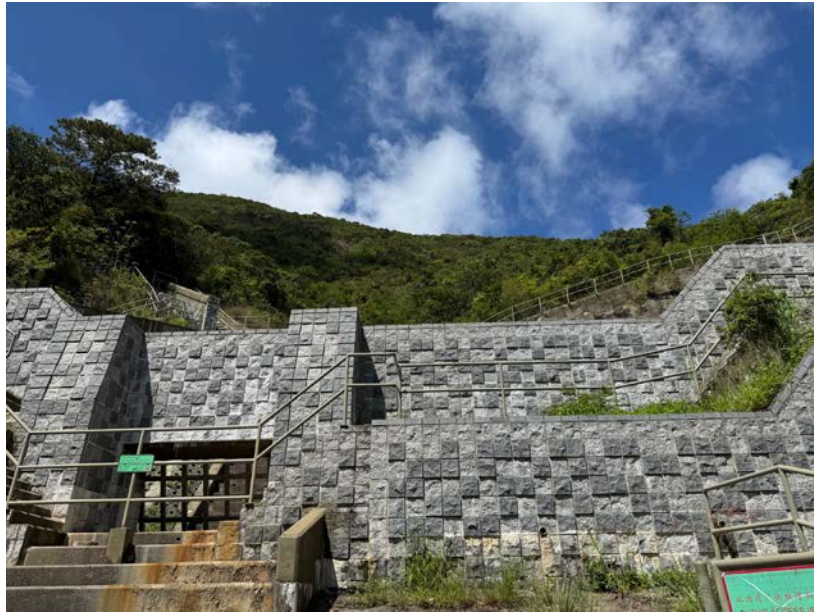
图 3：位于浅水湾道的泥石坝 (公署摄于 2025 年 5 月的实地视察)
