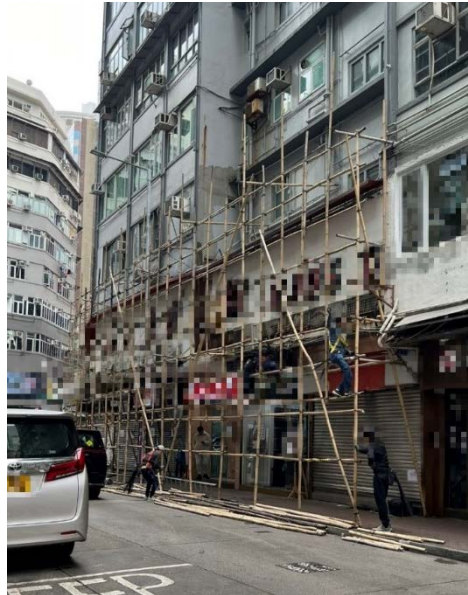
圖 9：竹棚架上的工人安全設備不足 (由公署人員於 2024 年 1 月拍攝)
