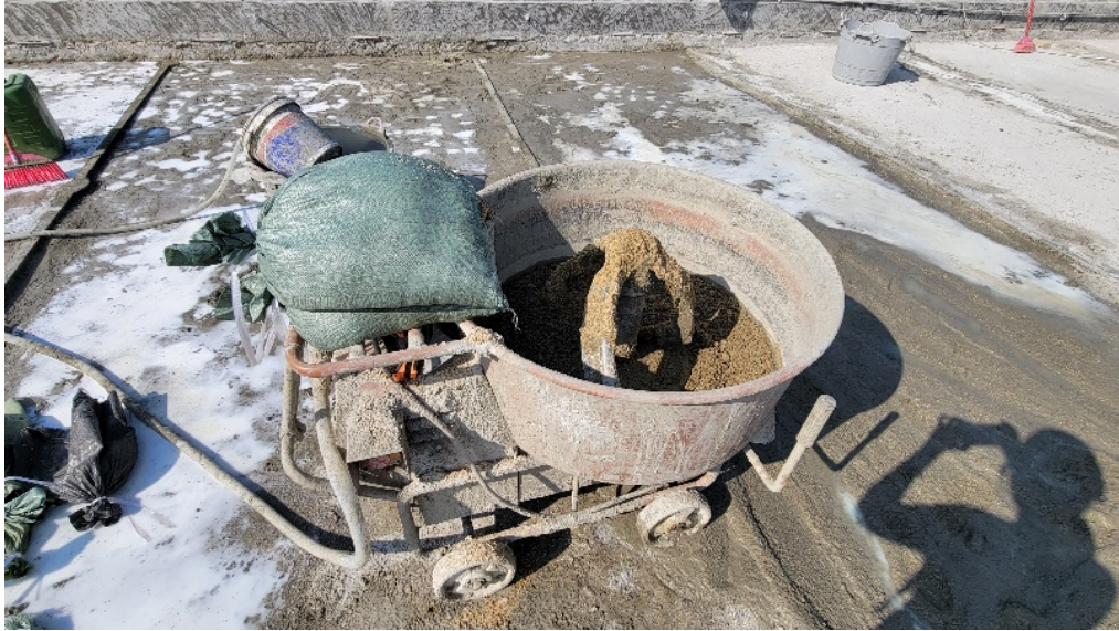
图 3：电动搅拌机开泥时未有使用安全罩 (由公署人员于 2024 年 1 月拍摄)
