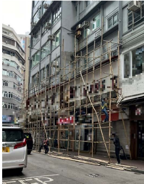
图 9：竹棚架上的工人安全设备不足 (由公署人员于 2024 年 1 月拍摄)
