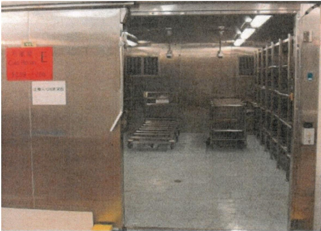
图 5：葵涌公众殓房内的临时遗体贮存装置
