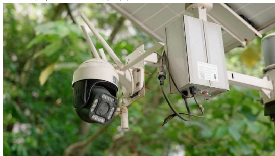
监测系统可实时监测排水口情况，适时作出跟进。
